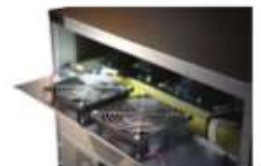
Ventiladores redundantes elevam a confiabilidade do sistema
